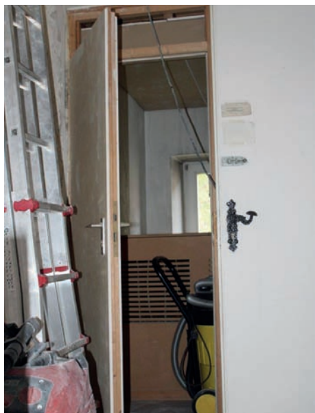
Die Staub und Feuchtigkeit ausgesetzte Kiste mit dem Orgelmotor in der Balgkammer
